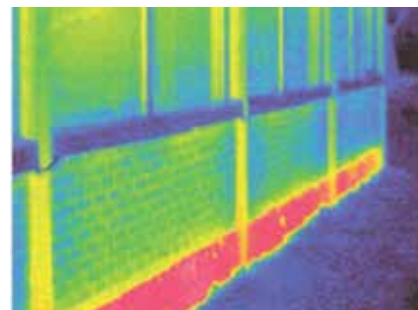
Näide külmasillast seina alaosas.
